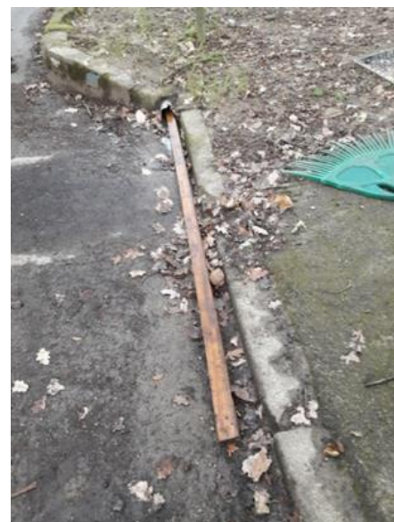
Exemple d'incivilité : tasseau retrouvé entièrement « coincé » dans le tuyau d'écoulement !!
